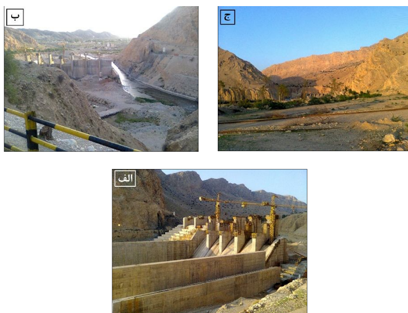
شکل ۲: رودخانه مارون و تجهیزات سد مارون الف و ب) دید به ترتیب به سمت شمال غرب و جنوب غرب سد تنظیمی در حال احداث بر روی رودخانه مارون، ج) نمایی از 'water gap' فعال در میانه تاقدیس خوب، دید به سمت شمال شرق
