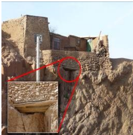
شکل ۸- نمونه‌ای از ساخت‌وساز غیر مجاز در حاشیه‌ی شهرک که نشانه‌ای بارز از دخالت انسان در تشدید فرایندهای مربوط به ناپایداری است.
