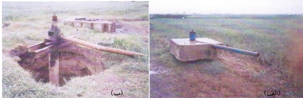
شکل ۱: لوله‌زایی در دشت گرگان (الف) در چاه پی‌زومتر عمیق (ب) در چاه عمیق بهره‌برداری (برگرفته از آرشیو شرکت آب منطقه‌ای استان گلستان)
